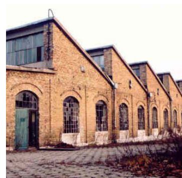
Shedtage på ældre industribygning.
