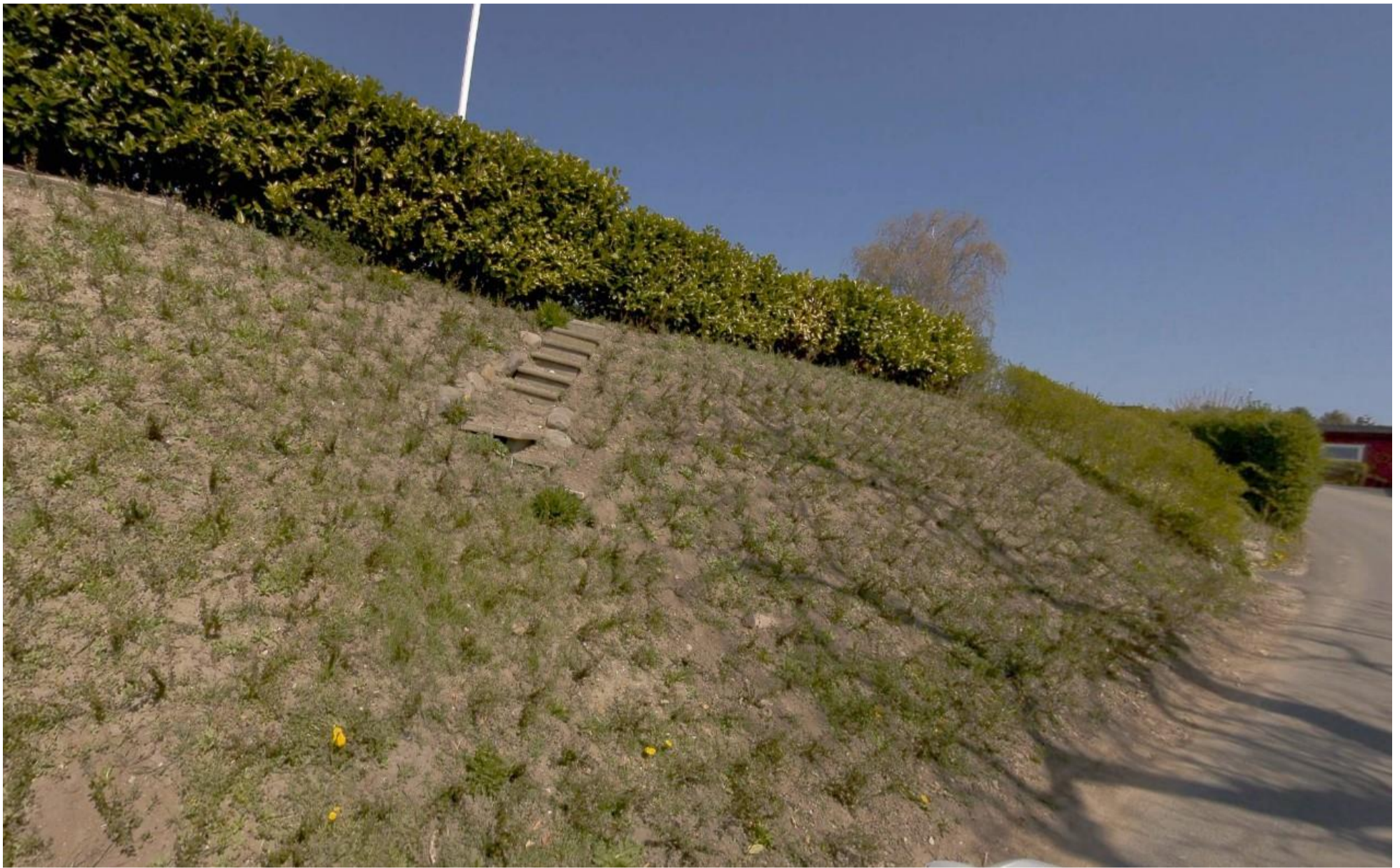
Skrænt for Violvænget 7 med delvist nedlagt trappe.
