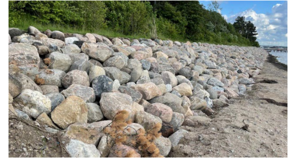
Figur 5: Kystsikring med stensætning
