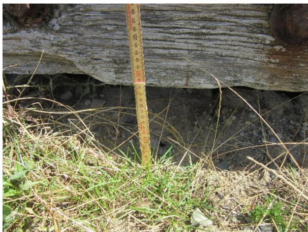
Figur 8: Jordfyldet er udvasket under hammeren.
