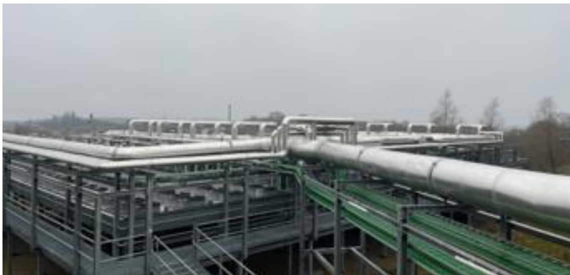
Figur 2: Svendborg Fjernvarmes varmepumpeanlæg, Bodøvej, som vil kunne forsynes med el fra det ansøgte VE-projekt
