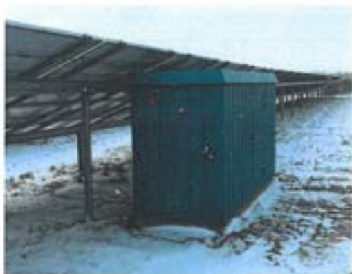
Foto - Eksempel på en teknikbygning, her en typisk fordelingstransformer.
