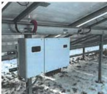
Foto - Eksempel på en inverter, placeret sammen med under- og hovedtavler, under solcellerne.
