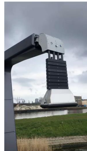
Figur 8 Oplæg til ladeanlæg i Svendborg
