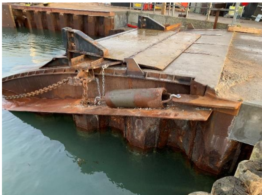
Figur 9 Eksisterende lejer for Højestene (Skarø) hvor der ikke er rampe på land.
