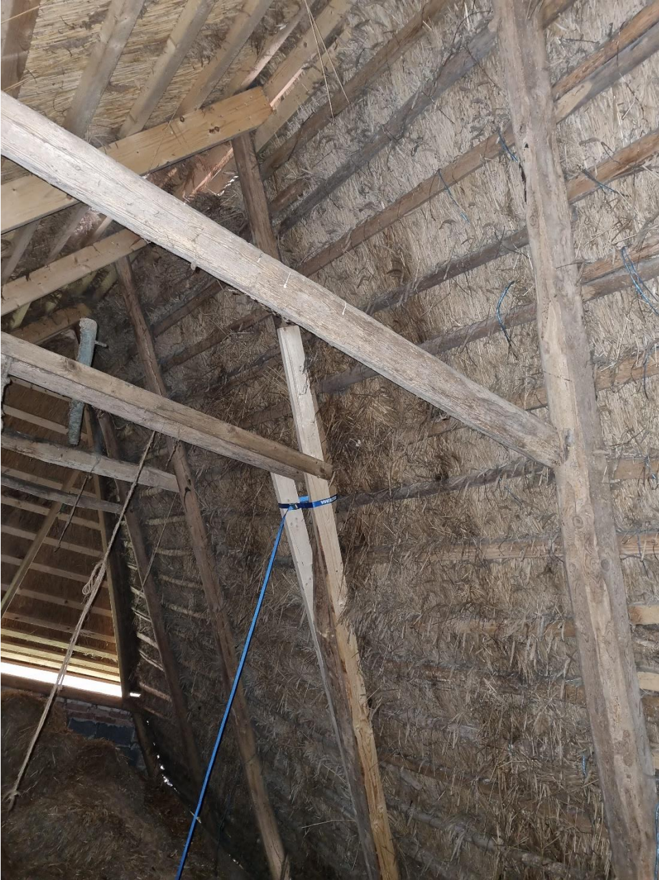
Figur 6 Viser spær der er knækket og hul i rygning
