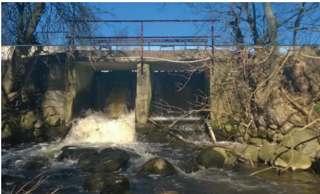
Opstemningen ved Gundestrup Mølle begrænser fiske- og dyrelivets frie bevægelse i vandløbet (foto: Rambøll).
