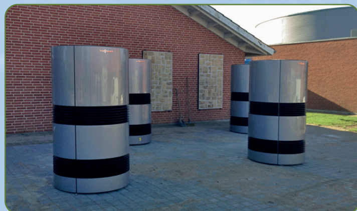
Varmepumper på Tåsingskolen, afdeling Sundhøj.
