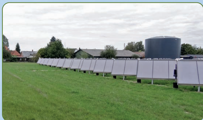
Solfangeranlæg ved Skårup Fjernvarme.
