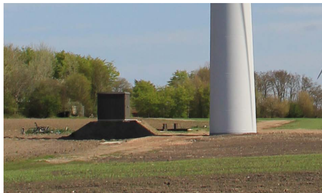
Foto af transformerstation på hævet placering ved mølle 2.
