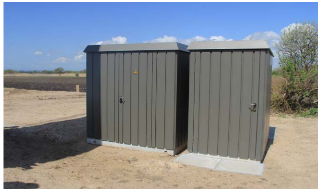
Foto af transformer- og koblingsstation ved mølle 1.
