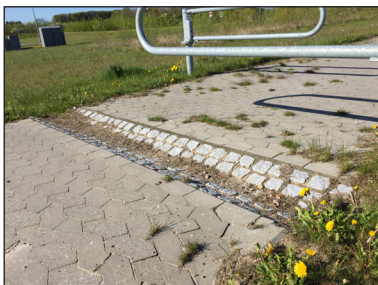
Eksempel fra lokalplanområdet, åben rende til overfladevand
