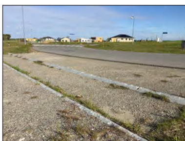
Eksempel fra lokalplanområdet på åben rende til afledning af regnvand
