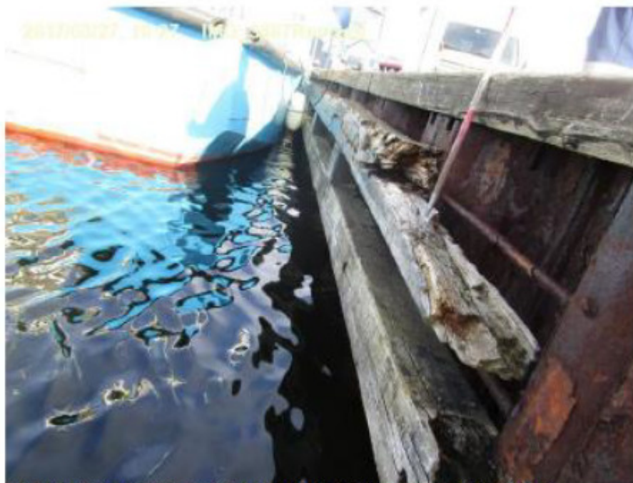
St. 67 (talt fra nordligvestligt hjørne), fenderløkker mangler lokalt.
