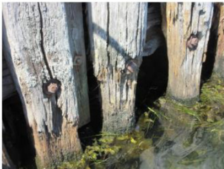
Kraftig råd og forvitring i splashzonen
