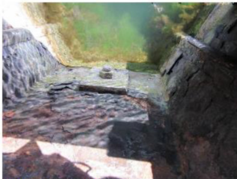
Lamineret korrosion ved splashzone
