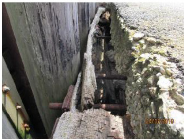
Nederste bjælke er udhulet og mangler lokalt helt.
