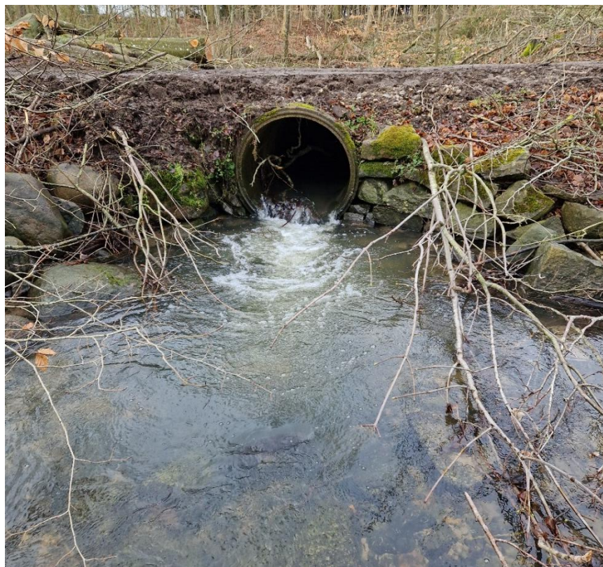
Figur 7: Rørgennemføringen i ca. st. 1.220 m.
