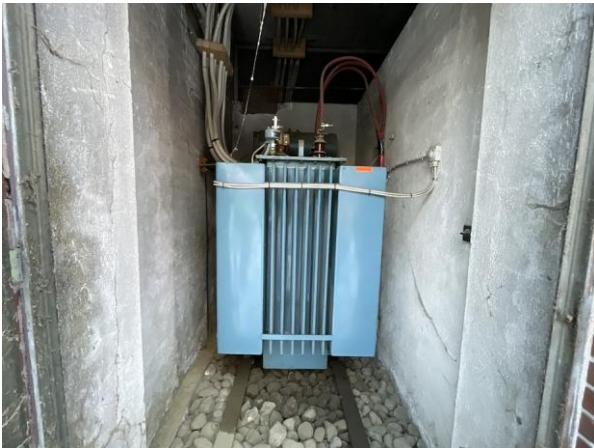
#8 Trafo A. Trafo B forventes at være tilsvarende
