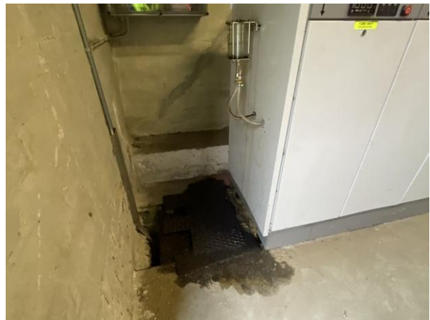
#11 Oliespild ved påfyldning til olieisolerede kabler i koblingsrum til trafo A og B, Pakhus 1
