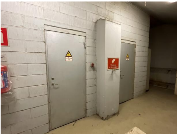
#18 Trafo D og E, pakhus 1, 2. sal
