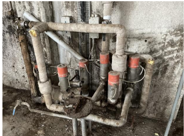
#23 Rørinstallationer isoleret med mineraluld (kun tynde rør). Pakhus 11, 3. sal
