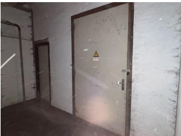
#12 Trafo C, adgang fra pakhus 2
