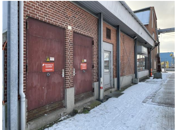
#9 Trafo A og B i pakhus 1
