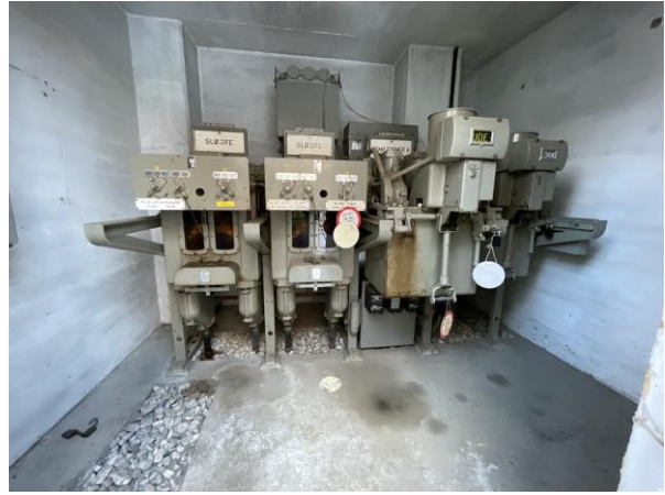
#15 Koblingsrum i pakhus 11
