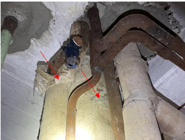
#24 Brud på lærred omkring Rørisolering med kiselgur. Pakhus 11, 1. sal
