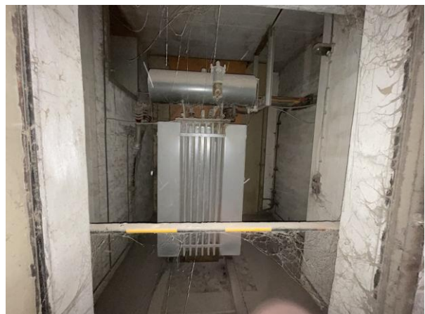
#13 Trafo C, pakhus 3
