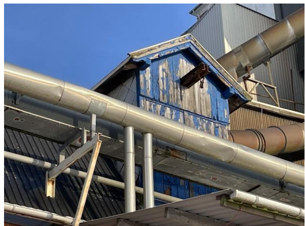
#6 Kvist på pakhus 1, malet træ og beklædning af fibercement (asbestholdig)
