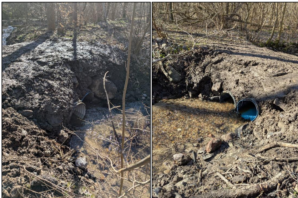
Figur 3: Billeder af etableret røroverkørsel fremsendt til kommunen marts 2025. På billedet til venstre vises overkørslen fra indløbssiden og billedet til højre side viser udløbssiden (Foto: Anders Ove Sehested).
