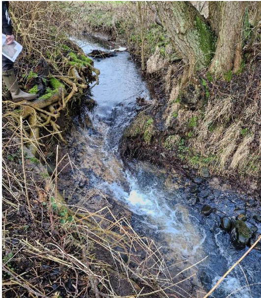
Figur 6: Billede af det eksisterende styrt i st. 510 m.
