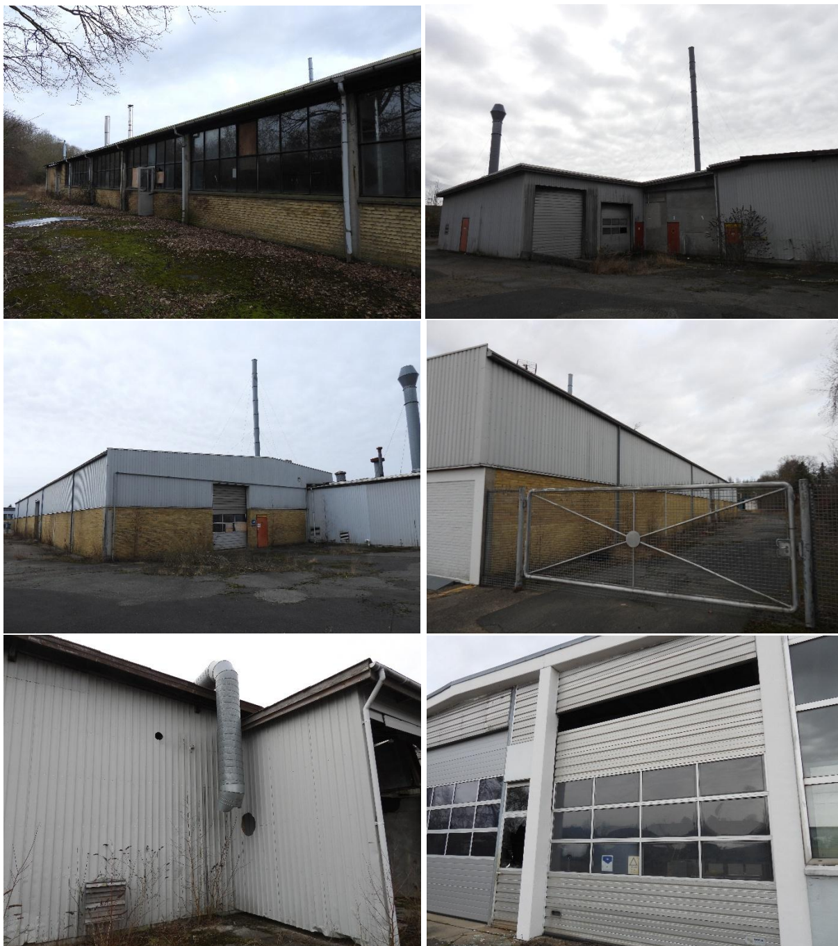
Figur 5.3 Billeder fra DMR A/S' besigtigelse d. 17. marts 2026. Bygning B1. Øv.tv. Nordlige side, set fra nordvest. Øv.th. Østlig side. Midt.tv. Sydøstligt hjørne. Midt.th. Sydlig side, set fra sydvest. Ned.tv. Hul i østlig væg. Ned.th. Knuste ruder og åben øvre portdel på vestlig side.
