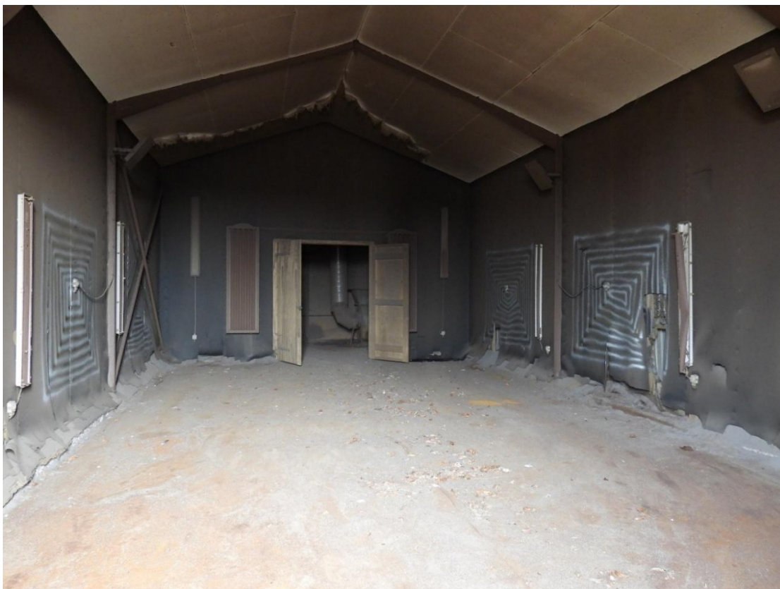
Figur 5.2 Foto fra DMR A/S' besigtigelse d. 17. marts 2026. Indre af Bygning B4. Bagerst ses åben indgang til bagvedliggende rum.
