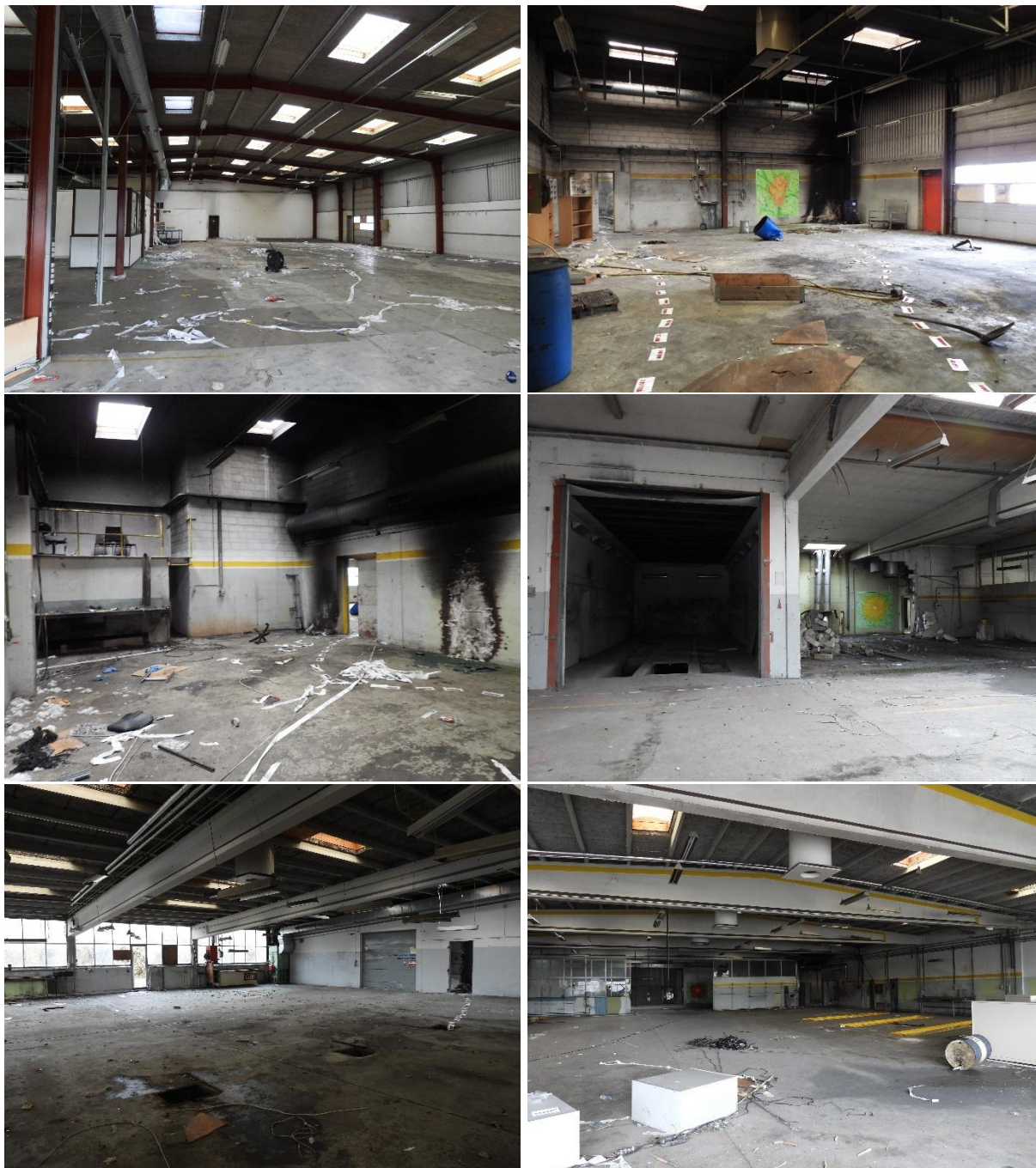
Figur 5.4 Billeder fra DMR A/S' besigtigelse d. 17. marts 2026. Bygning B1. Øv.tv. Sydlige hal. Øv.th. Østlig hal. Midt.tv. Mellemlokale mod sydøst. Midt.th. Mellemlokale mod nordøst. Ned.tv. Nordlig hal. Ned.th. Midterhal, mod vest. Her ses gule kanter til flere mekanikergrave.
