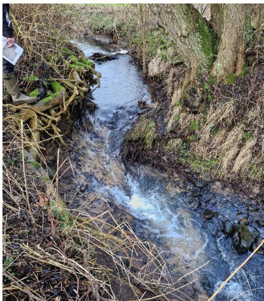
Figur 4-5: Billede af det eksisterende styrt i st. 510 m.
