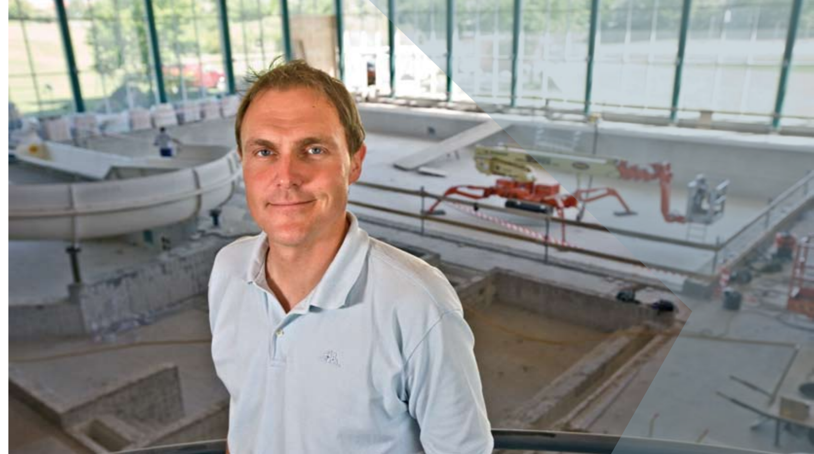
I øjeblikket er der ingen fliser i bassinerne i Svømmeland. Men Jan Damgaard leder af Svendborg Idrætscenter glæder sig til at vise den nyrenoverede svømmehal frem i august måned.
